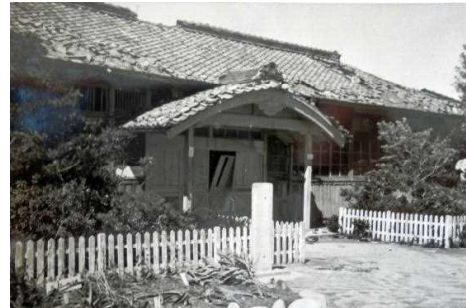
正面玄関の建物 瓦が多数飛びました
