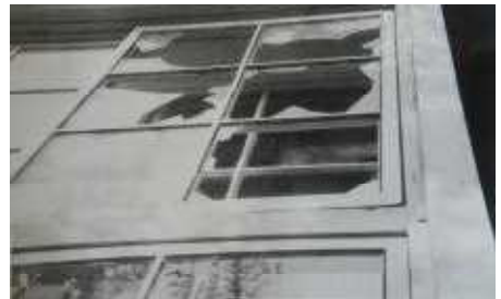
窓ガラスも多数割れてしまいました
