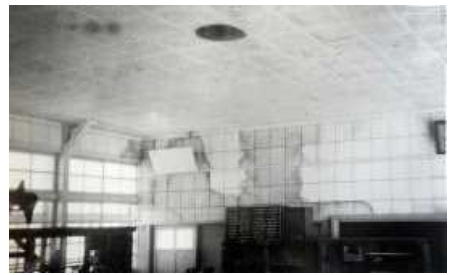
いたるところで雨漏りの跡が残りました
